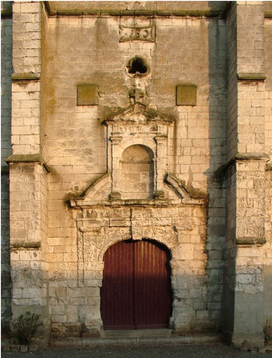
Le portail de l'église de La Chaussée-Tirancourt (Somme), portant la date de 1730.
