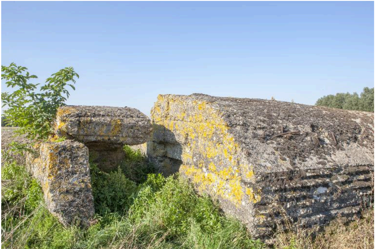
Dispositif pare-souffle de l'entrée ouest
