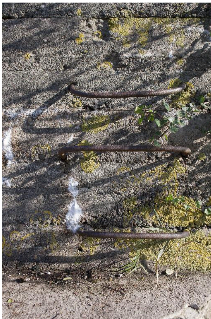
Echélons métalliques donnant accès au couvrement
