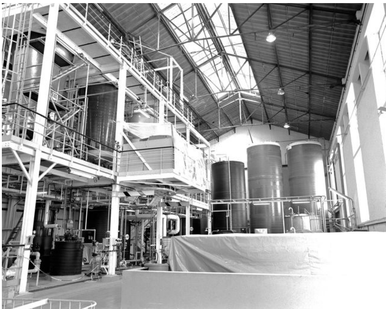
Chaufferie : vue intérieure.
