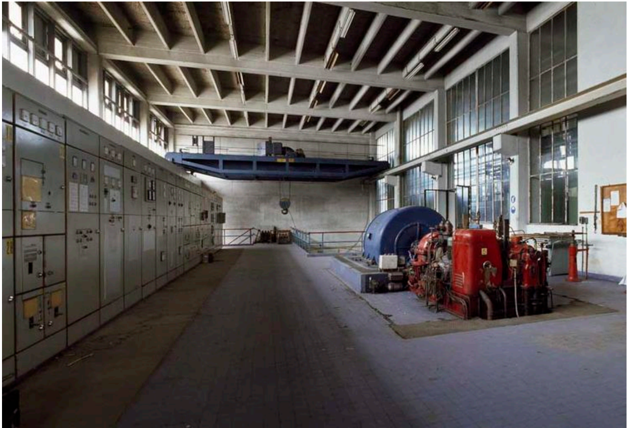
Turbine et alternateurs au premier étage de la centrale.
