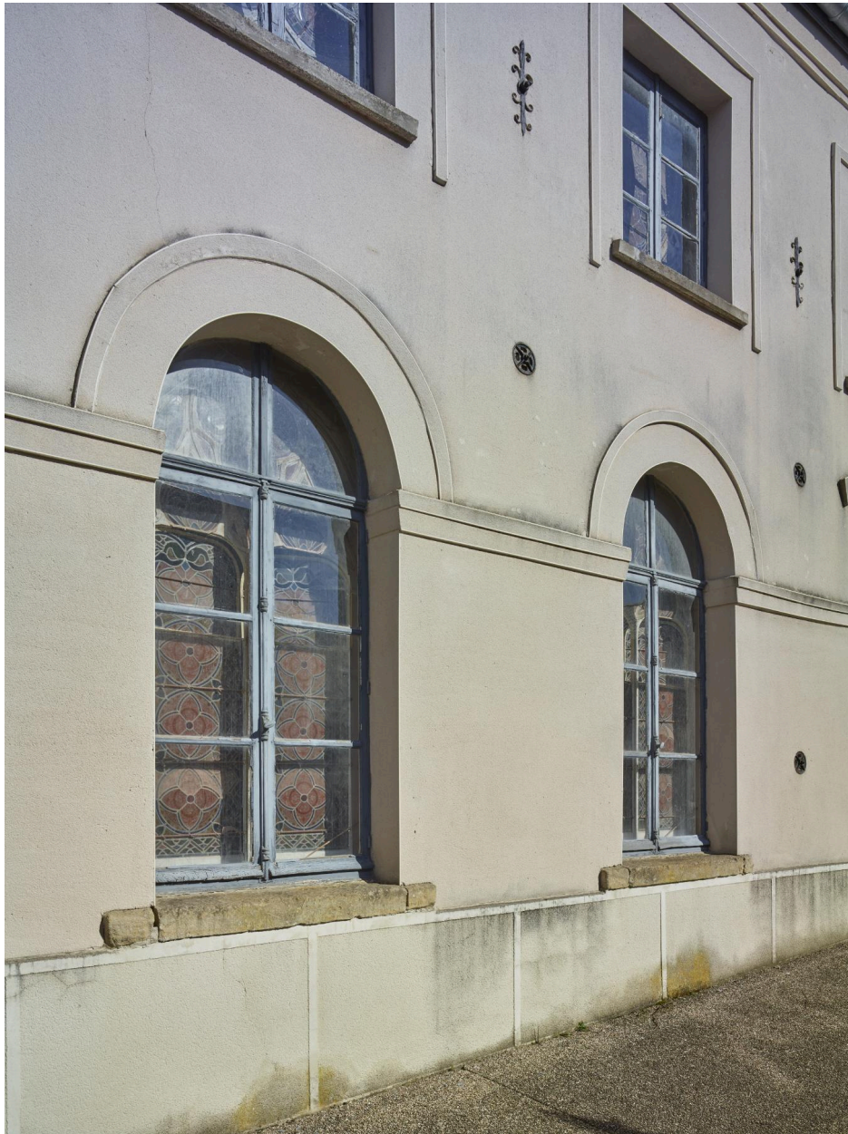
Vue de détail des baies et du positionnement des fers d'ancrage sur la façade ouest.
