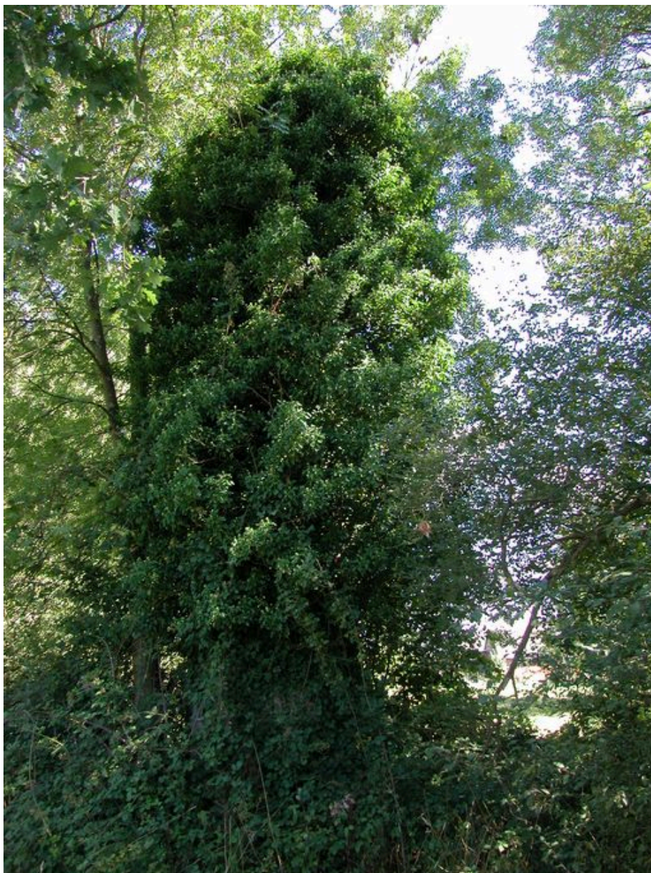
La cheminée en brique envahie par la végétation.
