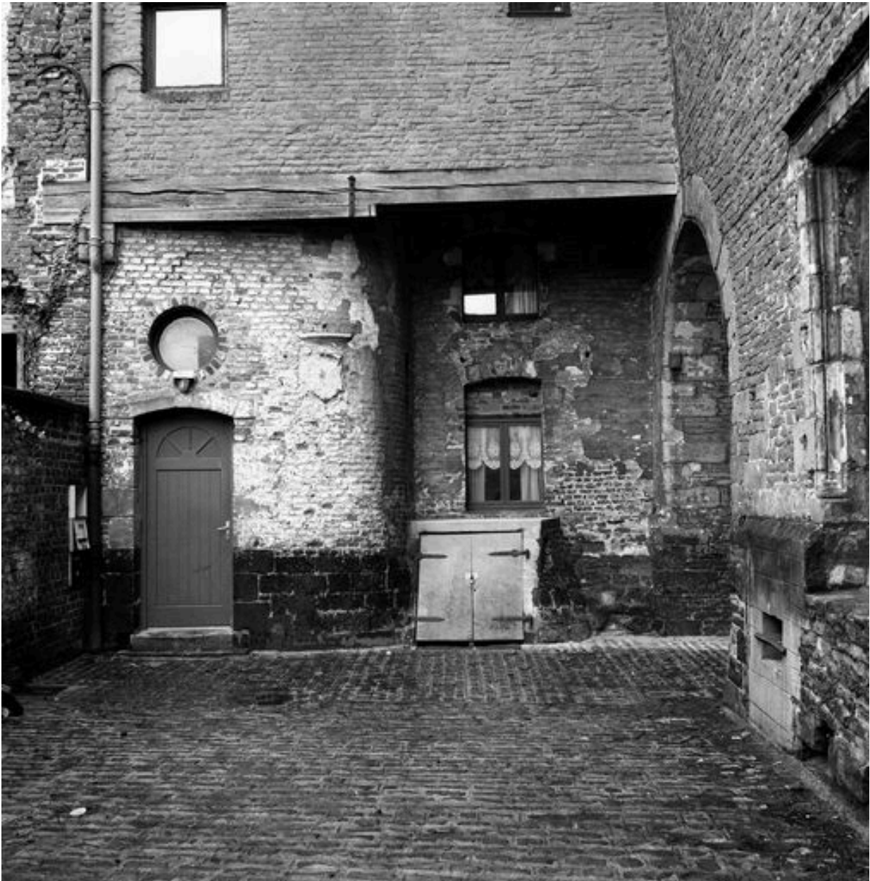
Aile de la rue de la Bibliothèque : vue depuis la cour du château, vue partielle : les deux premières travées, raccordées au corps de bâtiment médiéval, rez-de-chaussée.
