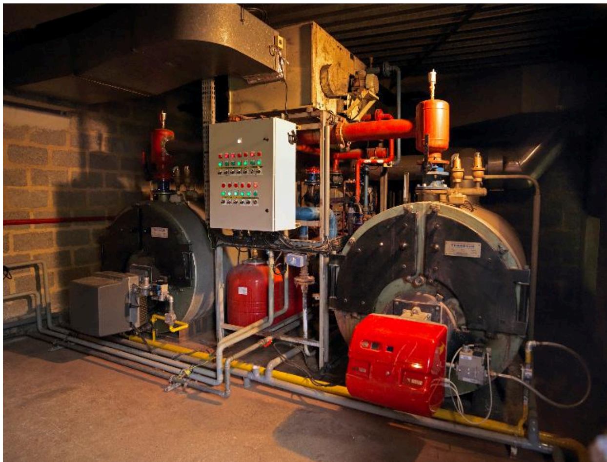
Local technique : chaudières.
