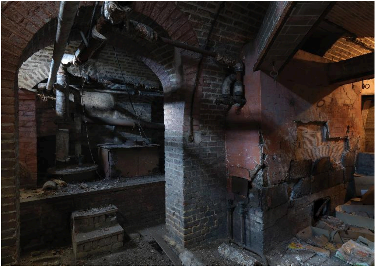
La chaudière située au sous-sol du château.
