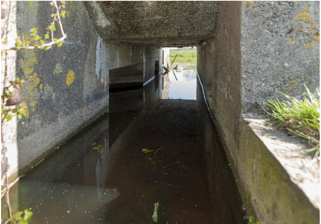
Entrée inondée sous le porche pare-souffle
