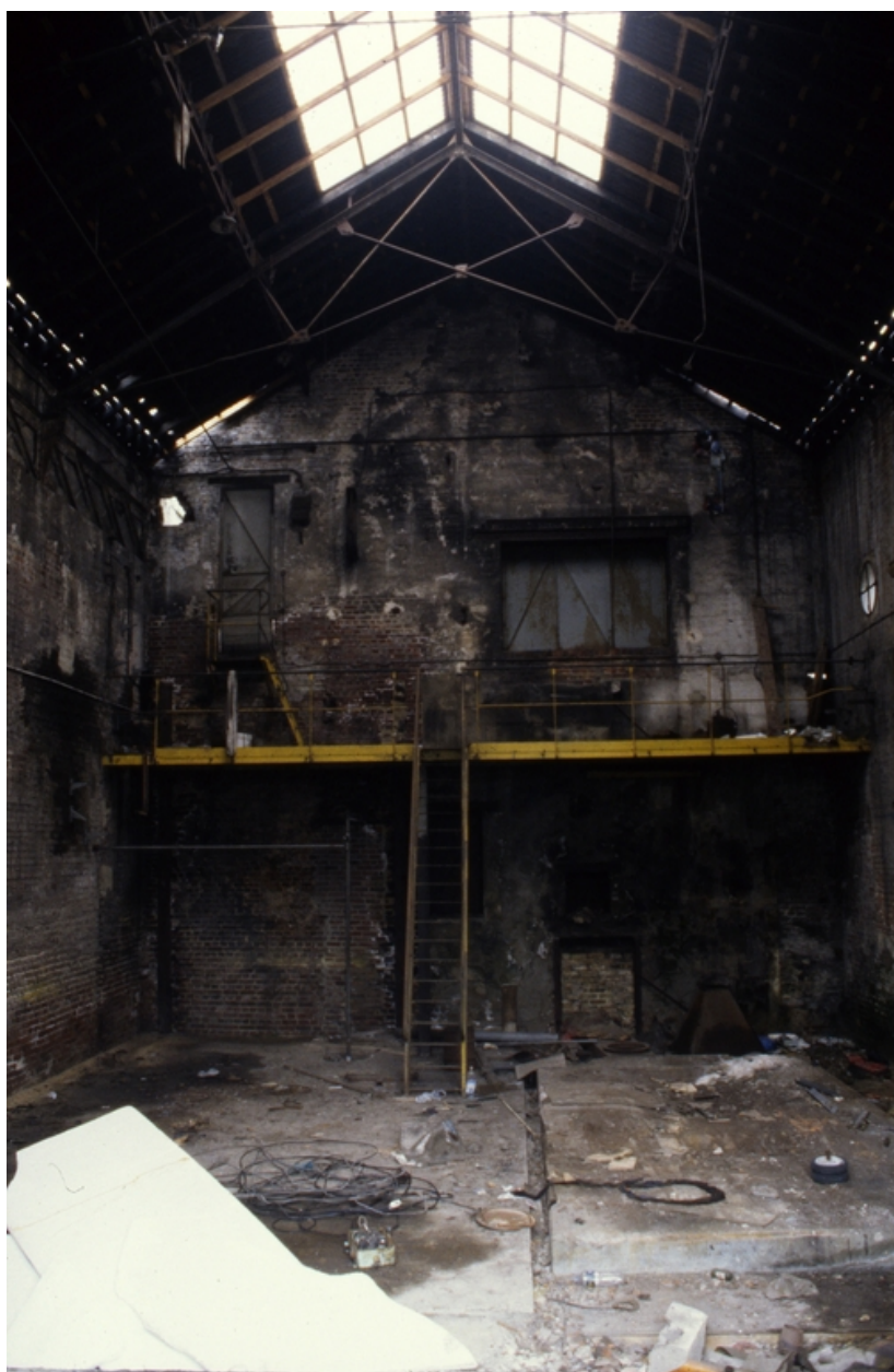
Vue intérieure de la chaufferie, 2001.
