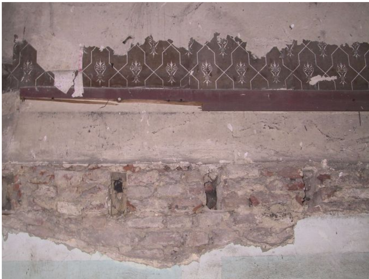
Intérieur, étage, salle de spectacle : arrachement du balcon et lambeaux de papier peint, état en 2005.
