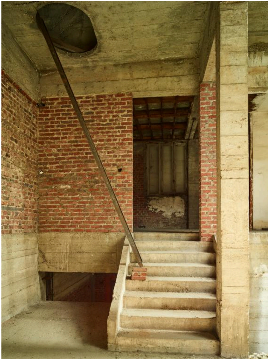
Ancienne cour couverte à marchandises, détail de l'accès latéral aux espaces de vente.
