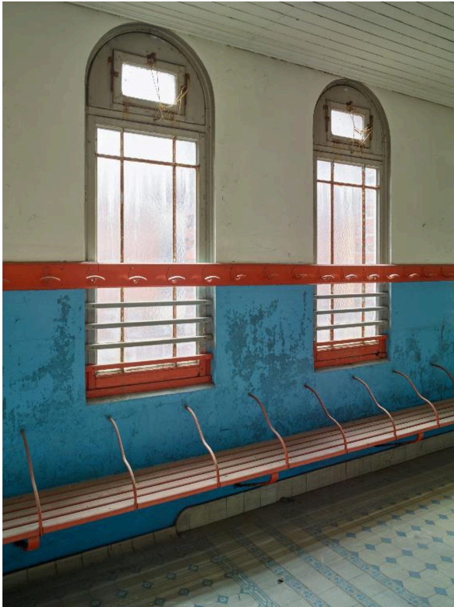
Aile nord, premier étage. Ancienne hydrothérapie des bains de luxe pour hommes, réaménagée en vestiaire collectif. Détail des fenêtres et du mobilier.
