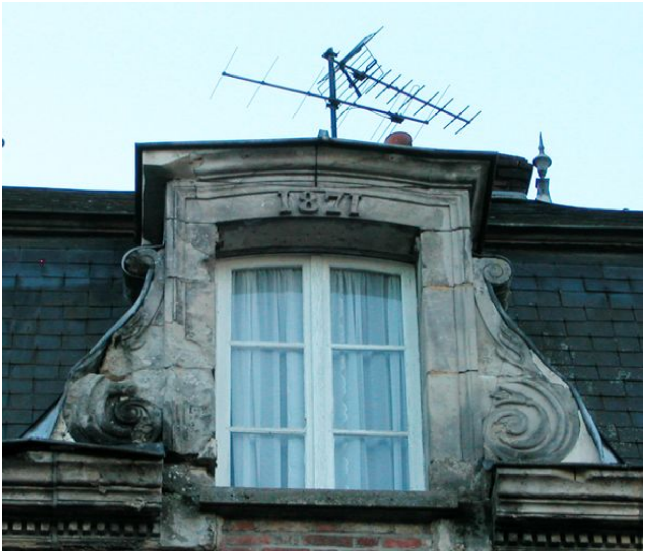
Logement patronal, détail de la lucarne de toit portant la date de 1871.
