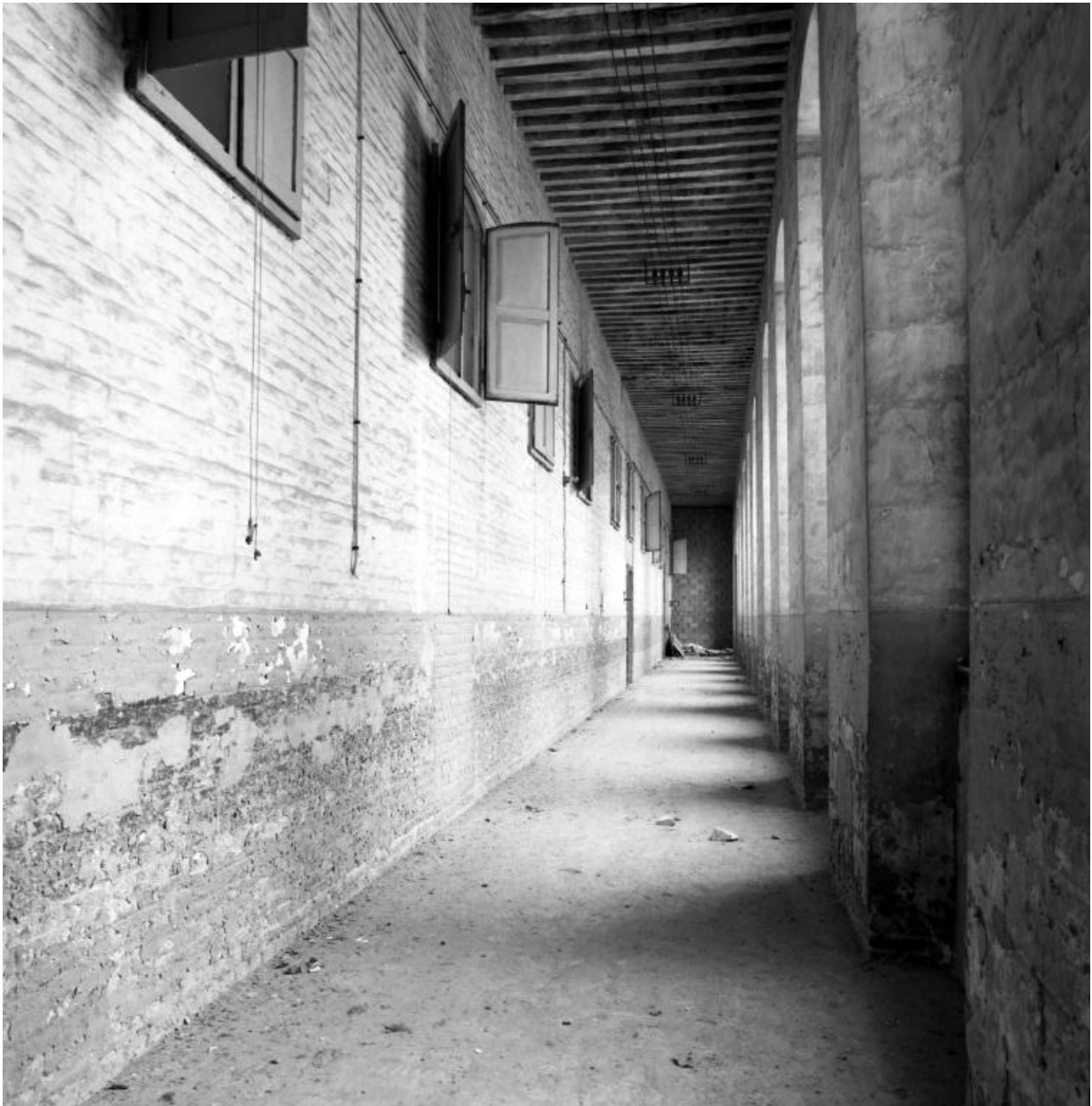
Galerie de distribution du 1er étage d'un des bâtiments bordant la cour d'honneur, vue en enfilade.
