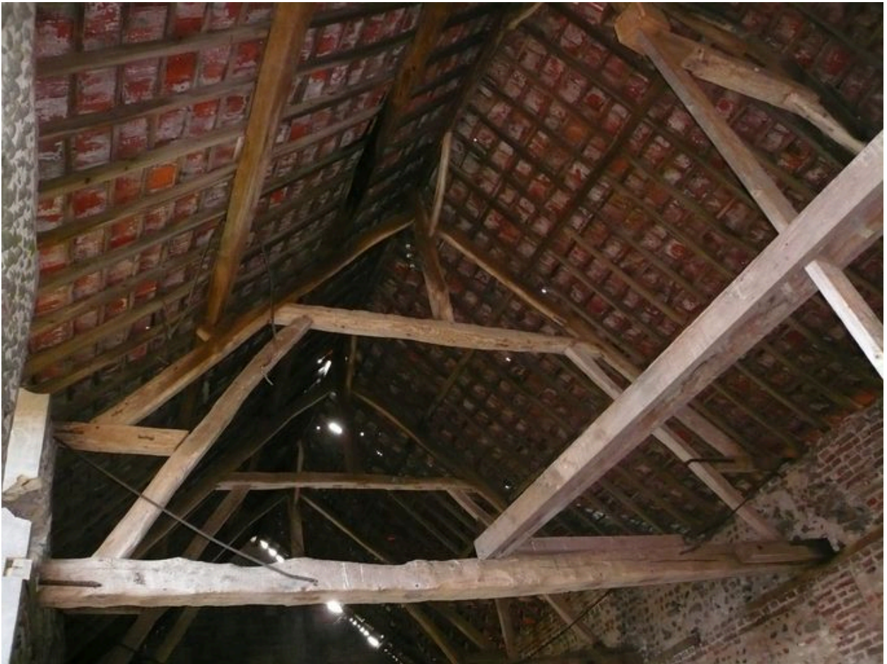
Vue d'une ferme de la cossetterie.
