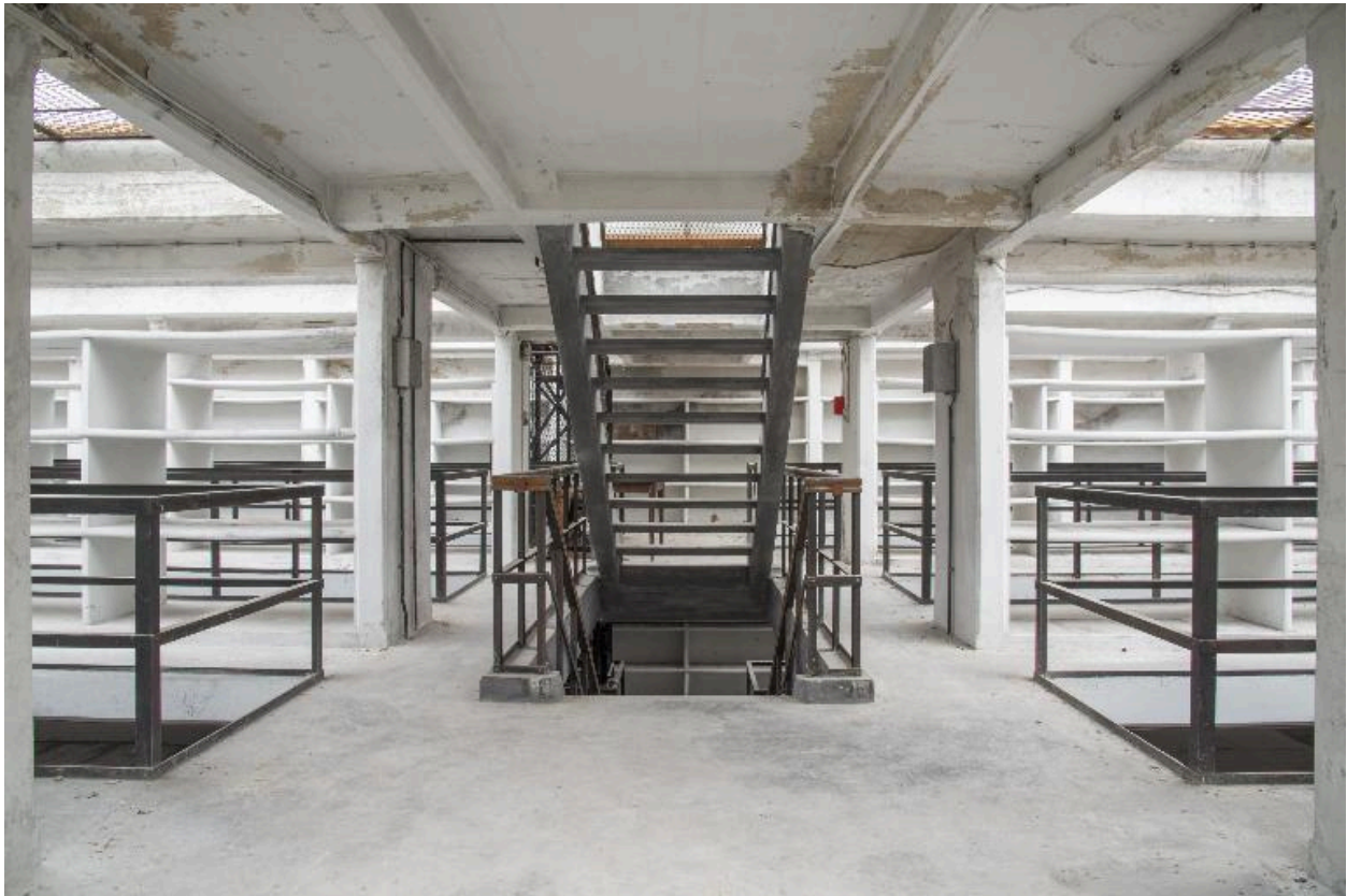
Bâtiment du dépôt, troisième étage : vue de l'escalier depuis le vaisseau 4, vers le nord.
