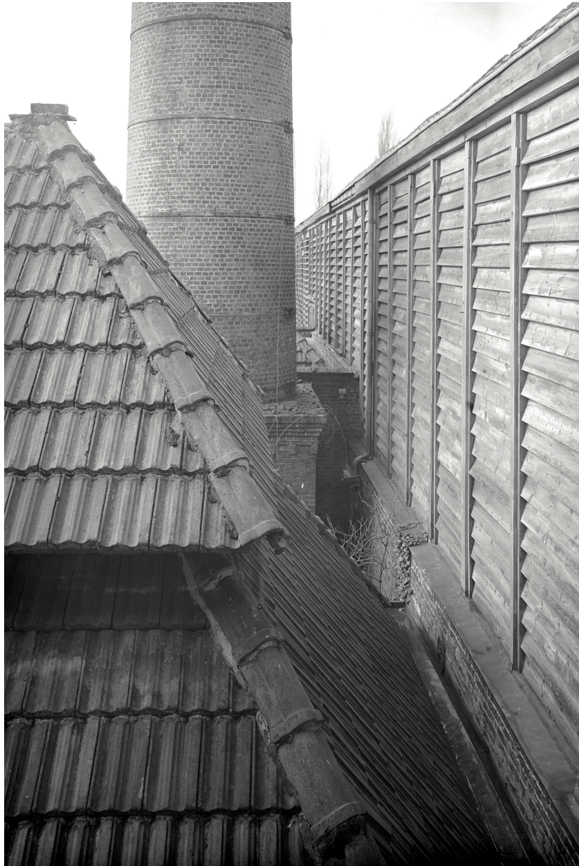
Atelier de débouillissage (C) : détail de la couverture. À droite, l'abat-vent de la pièce de séchage (B) en position fermée.
