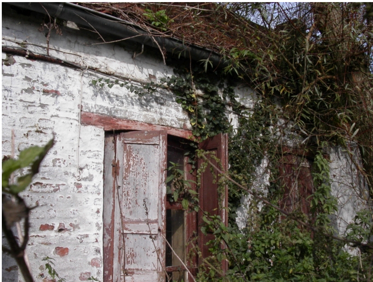
Logis situé 641, rue de la Pulmez, vue depuis la rue : linteau de fenêtre en bois (avec cintre), détail du logis (à l'abandon).
