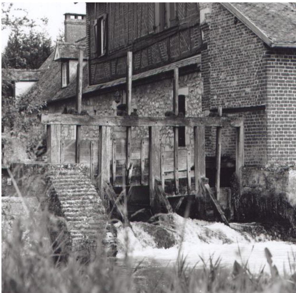
Les vannes de décharge.
