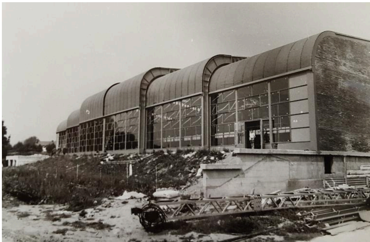
Vue de la piscine en construction, façade sud. Juillet 1967. Photo : Société MacGregor-Comarain (AN ; 19840036/145).
